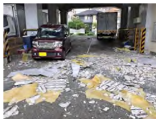
コンクリート1.3トン分落下 JR神戸線の高架橋 2019/8/25 https://www.nikkei.com/article/DGXMZ048978150V20C19A800000/
