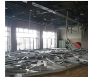
①建物の屋根被害
