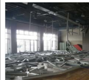
①建物の屋根被害
