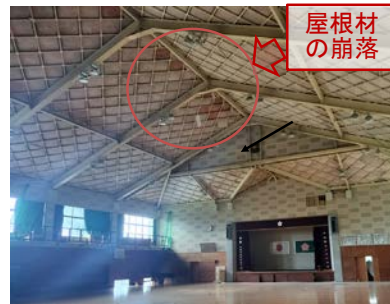
②屋根材の崩落
