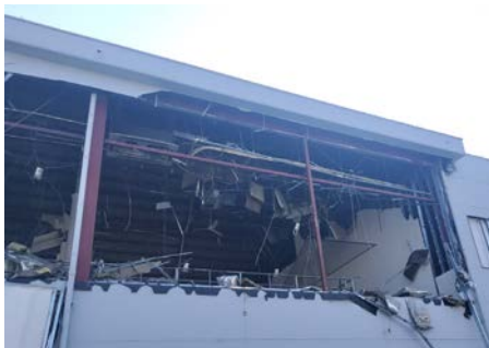
③建物の外装材の崩落
